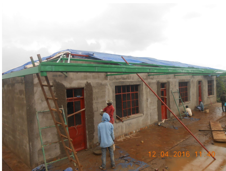
Abbildung 15: April 2016: Dachrinnen, -anstrich und Türen
