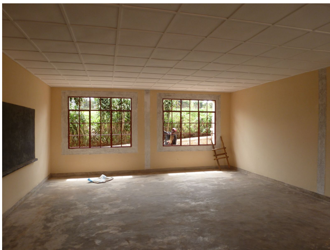
Abbildung 43: Innenanstrich Klassenräume, Tafeln (Juni 2018)
