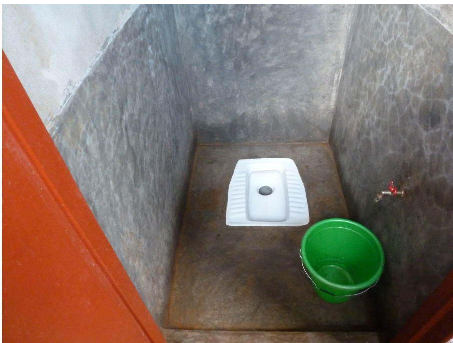
Abbildung 73: Eine Toilette mit Spülung
